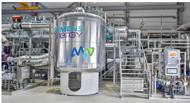
Ein Meilenstein auf dem Weg zur Umsetzung der Energiewende: die MVV-Flusswärmepumpe auf dem Gelände des Grosskraftwerks Mannheim
