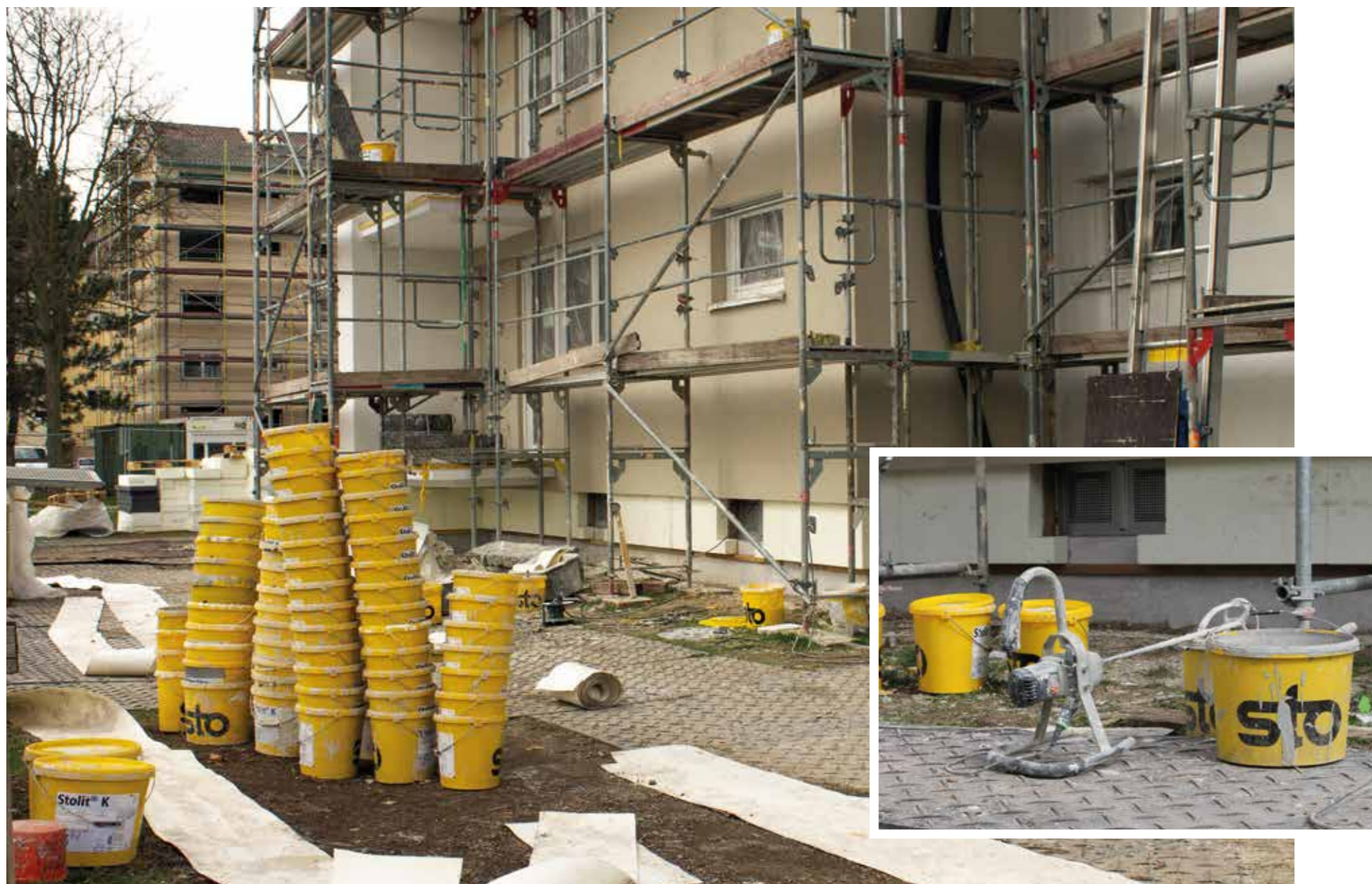
Die Stadt baut nicht nur, sondern saniert auch ältere Gebäude, wie hier in Schönau Nord-West. Im Rahmen ihrer derzeit größten Sanierungsmaßnahme modernisiert die städtische Wohnungsbaugesellschaft GBG rund 1.700 Wohnungen.
