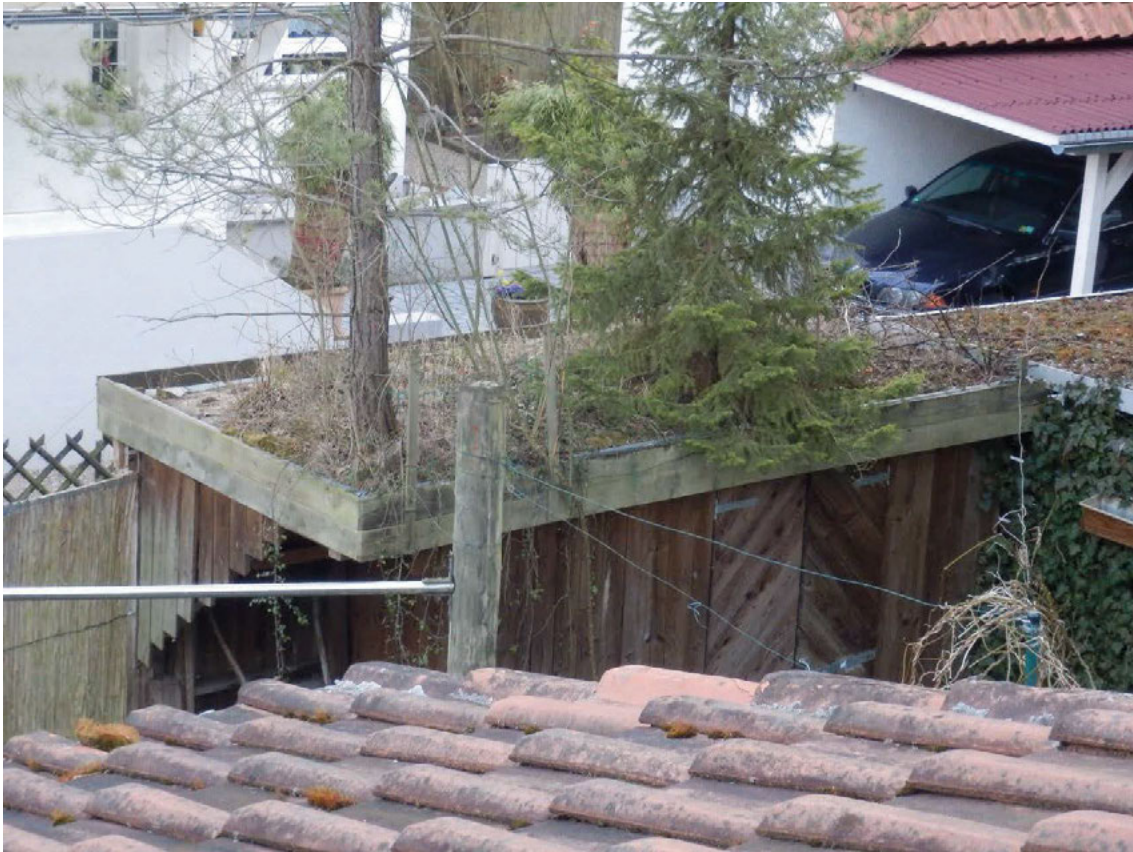
Abbildung 5: Nicht gepflegte extensive Dachbegrünung; Fremdbewuchs wurde nicht entfernt
