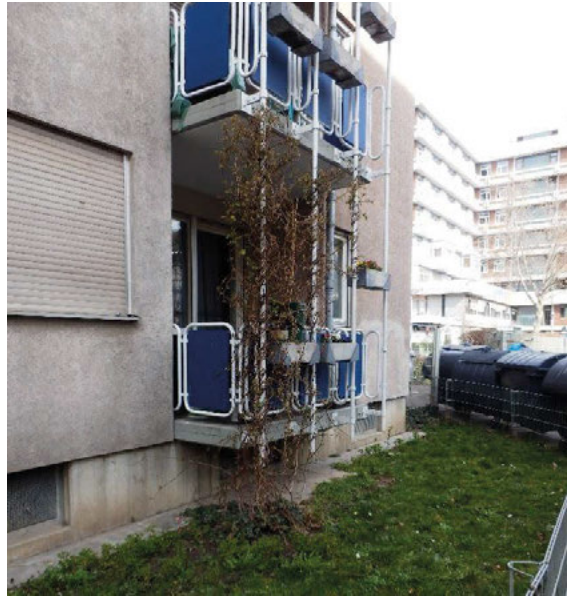
Abbildung 29: Balkon mit Bewuchs an der Südostseite von H5
