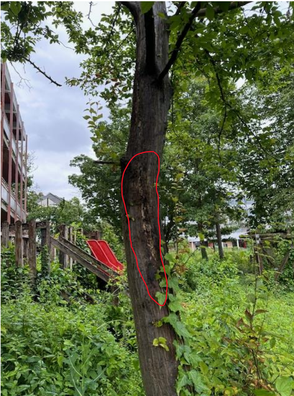
Abbildung 10 innerhalb der roten Markierung ist deutlich ein Riss mit weitreichender Fäule erkennbar
