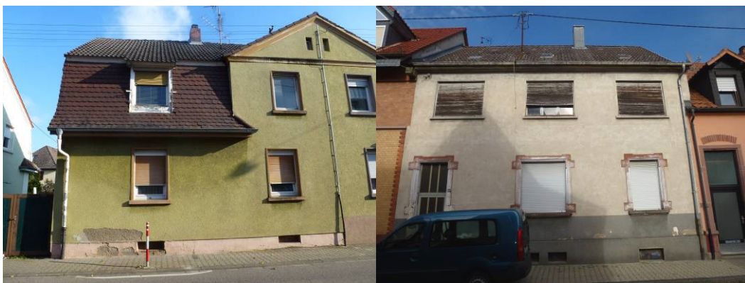
Abbildung 27: Gebäude mit deutlich sichtbaren baulichen Schäden und umfassendem Sanierungsbedarf (Quelle: Fotodokumentation)
