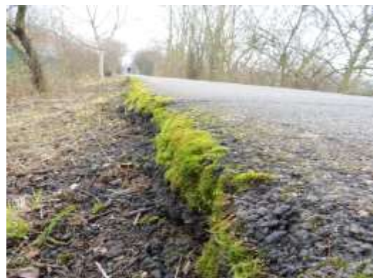
Zustand der Wegedecke des Radwegs entlang des Neckarkanals
